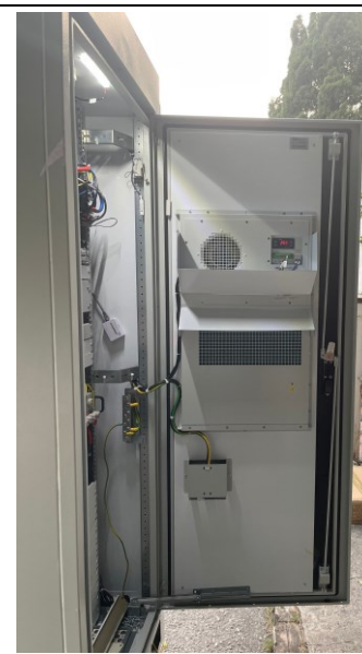
Hình 1.6: Điều hoà làm mát gắn trên cánh tủ
