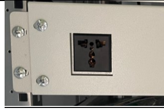
Hình 1.10: Ổ cắm điện 220V-10A
