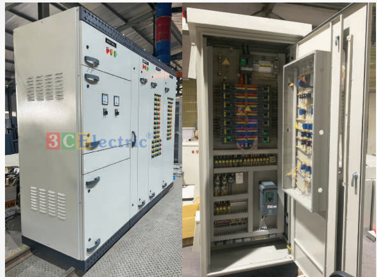
TỦ ĐK ĐỘNG CƠ MCC
