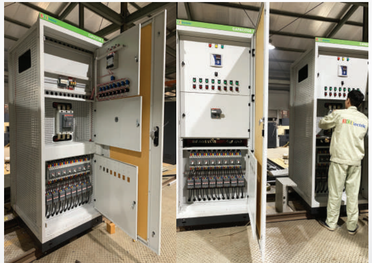
TỦ TỰ BÙ CAP
